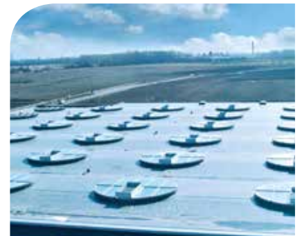
Kreisrunde Glasoberlichter mit Sonnenschutzverglasung sowie NRA-Anlagen auf einem Integrationszentrum
