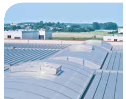
Eingebautes Lichtband über einer Durchfahrtsstraße mit integriertem Rauch- und Wärmeabzug
