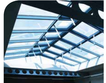
Oberlicht mit Stegmehrfachplatten aus Polycarbonat, 9 m breit
